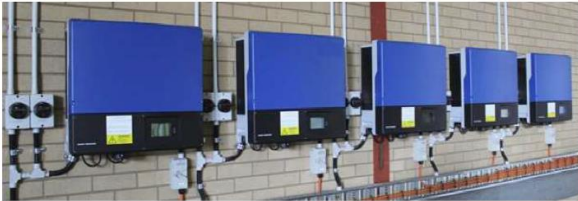
Slika 7 Razdjelni ormari sadrže DC i AC rastavnu i zaštitnu opremu
