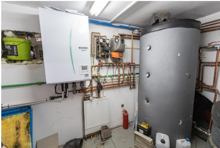
Slika 11: Sustav grijanja vode pomoću vakuumskih solarnih kolektora obitelji Zovko
