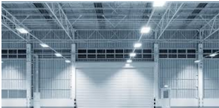
Slika 14. LED rasvjetna tijela u skladištu
