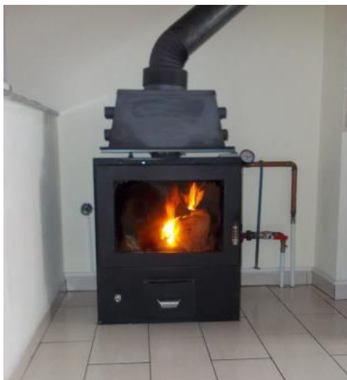
Slika 19. Kamin za centralno grijanje na drva
